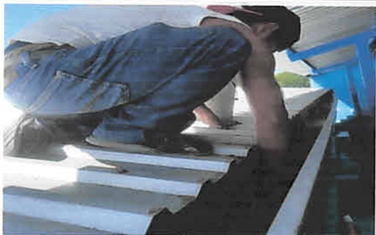
Foto1: CANALES EN MAL ESTADO DE LA GALERA
