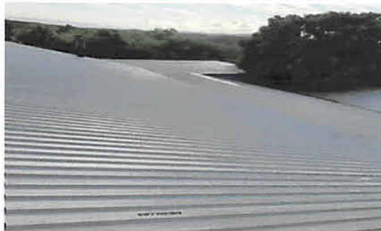
Foto 4: TECHO DE GALERA EN MAL ESTADO
